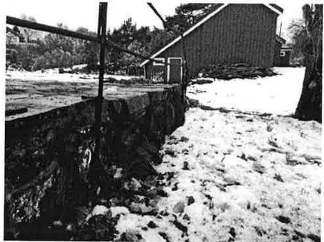
Utglidning opprinnelig grunnmur
