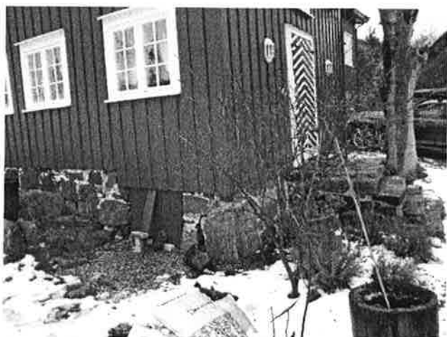
Borøykilveien 50, utglidning av opprinnelig stein mur
