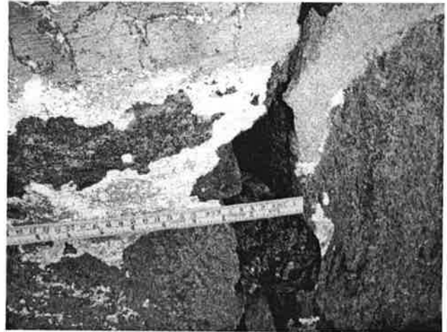
Sprekke i grunnmur, målt til 6-7 cm under befarings
