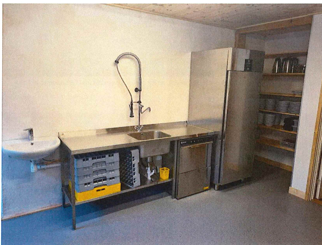
Skitten sone med håndvask, utslags-/spylevask og damp-vaskemaskin.
