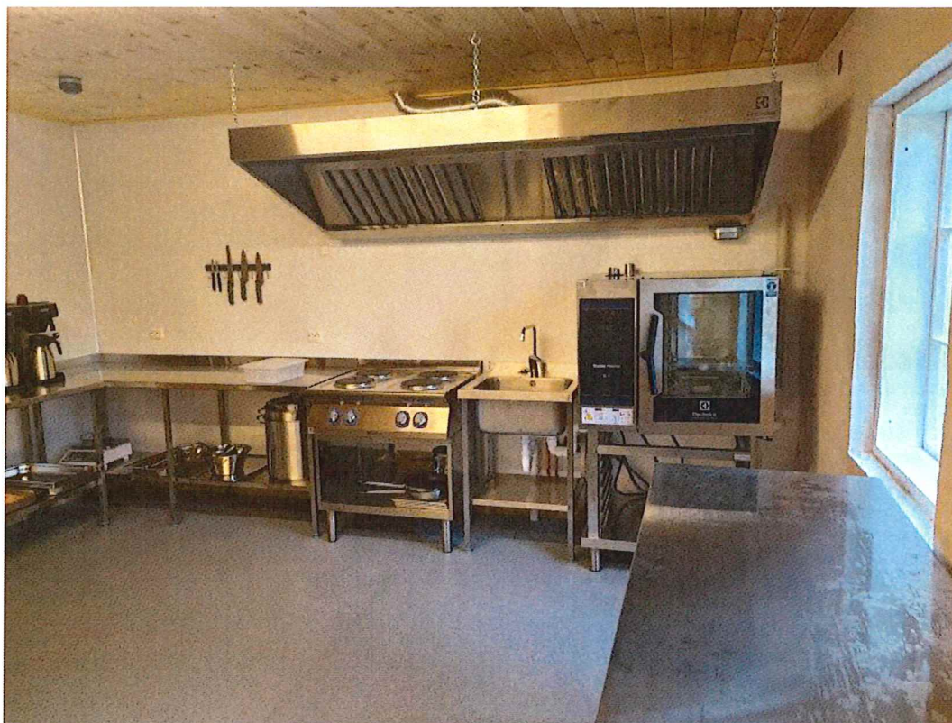
Vi kom i mål. Kokeopp, kombidamper, stålbenker, småutstyr, stor kjøll og hylleplasser.
