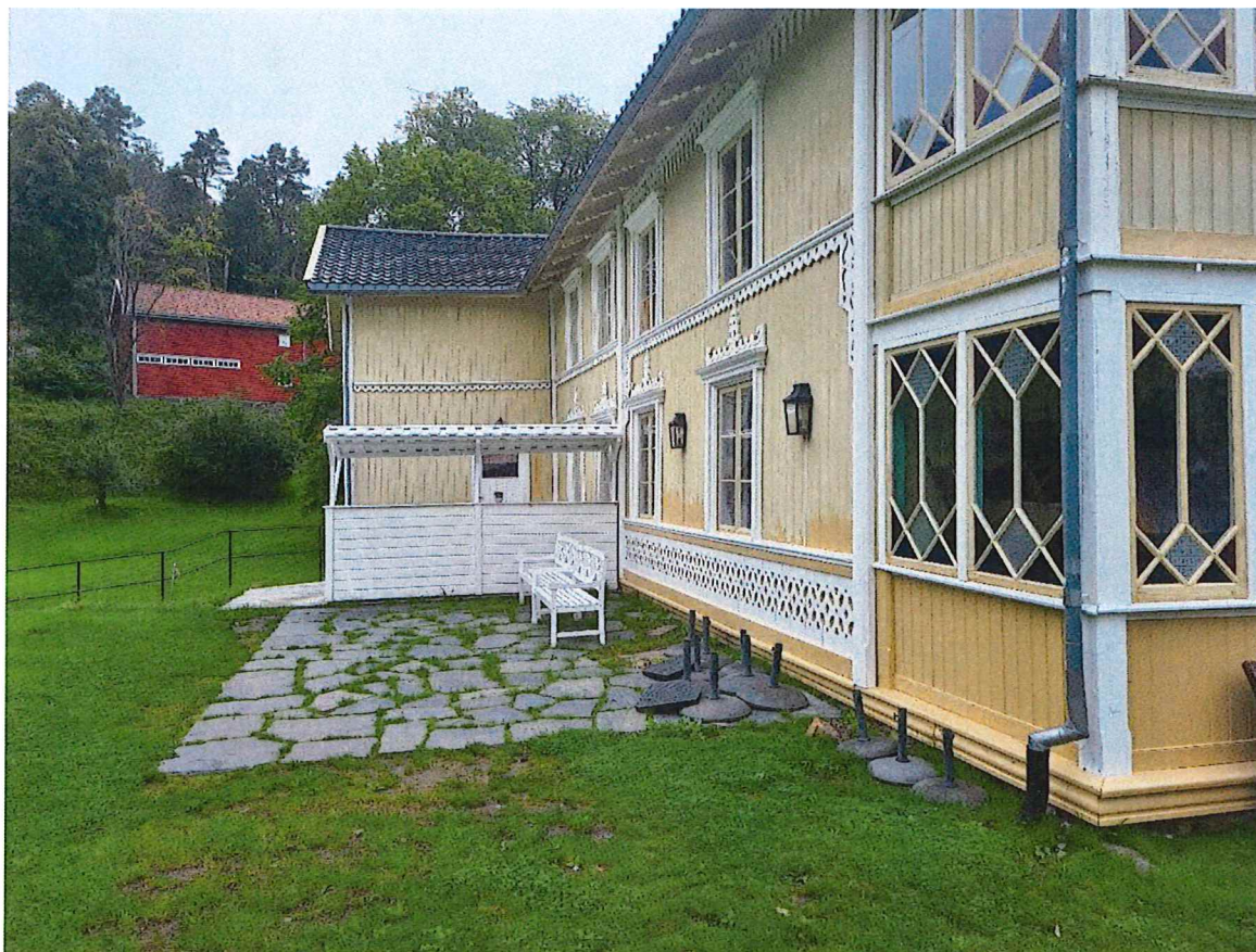
Nedre del av bygningen var veldig slitt og fortjente litt omsorg med linoljemaling.
