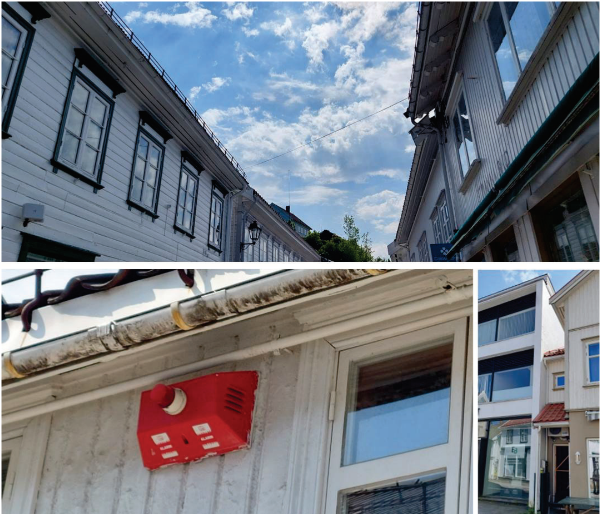
Figur 9 Hovedgata (handelssentrum). Eksempler på tørrsprinkleranlegg under gesims og murbygg mellom trehus
