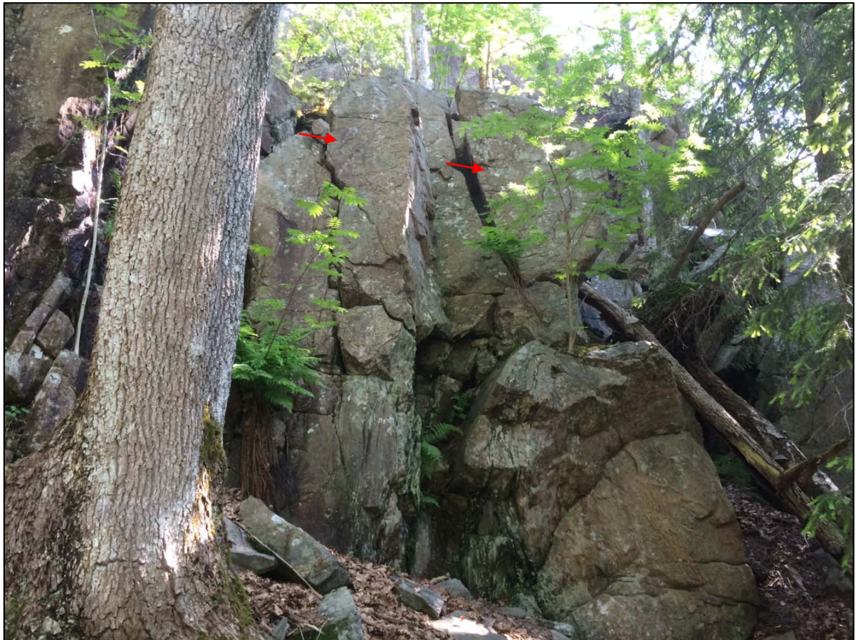
Figur 7. Avløste blokker (røde piler) i steil fjellskrent
